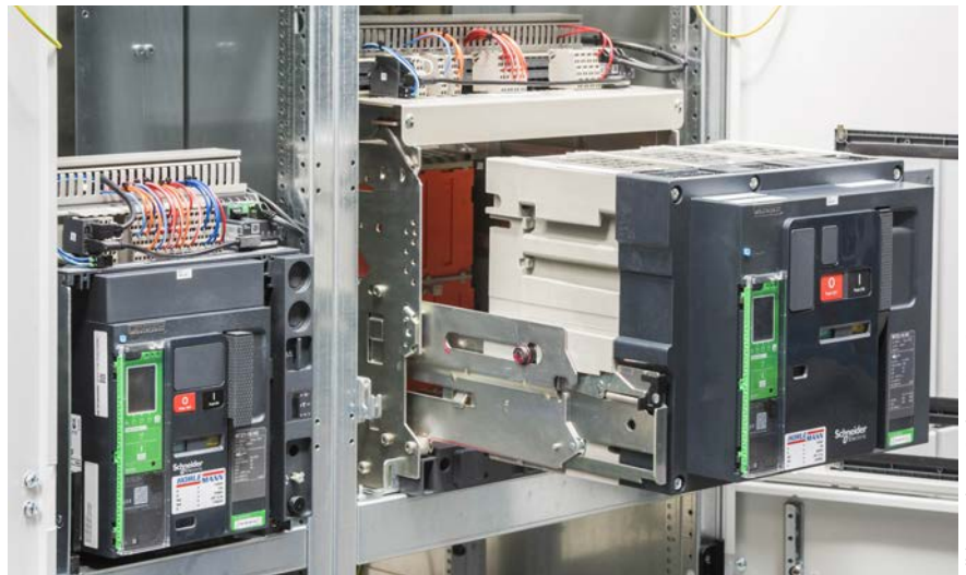
Bild 3 | Mit den Masterpact MTZ von Schneider Electric kommen offene Leistungsschalter der neuesten Generation zum Einsatz.
