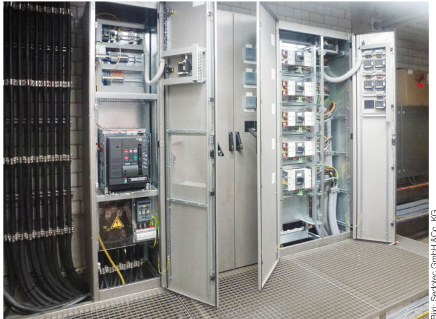
Bild 3 | Besondere Herausforderung an das Wärmemanagement: Die absolut dichte Vamocon-Anlage in Edelstahl in der Station Eiswasser.
